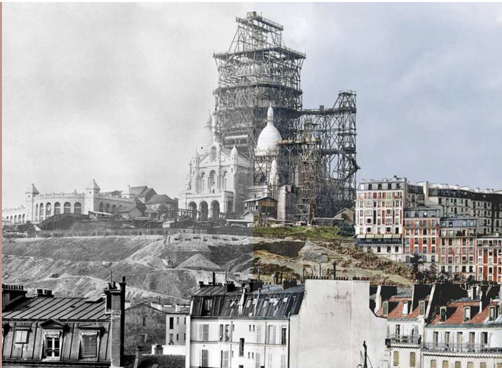
Construcción de la Basílica dedicada al Sagrado Corazón en París (Montmartre), foto de 1890
